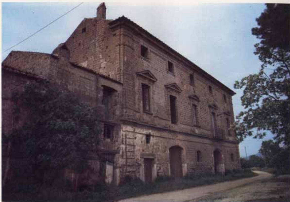
Fot. 45. - Palazzo Silvagni a Capua . Edificato nel XIX secolo, disabitato ed in cattivo stato di conservazione, nonostante i lavori di parziale ristrutturazione già eseguiti, presenta una struttura lineare ed è su tre livelli con sottotetto, utilizzato come granaio. Assolveva ad una funzione agricolo-residenziale perché l'annesso fondo era utilizzato per colture seminative, mentre oggi ospita un frutteto, irrigato da alcuni pozzi costruiti nella zona. Classico esempio di palazzo di pianura contornato da fondo rustico, con depositi di prodotti ed attrezzi vari, un tempo disponeva di un ampio giardino, protetto da un muro di cinta.
