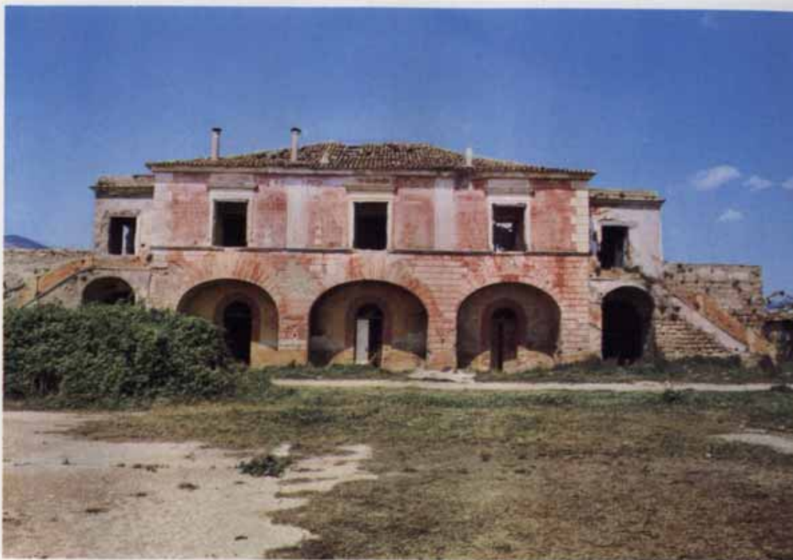
Fot. 17. - Masseria Torre Vecchia a Falciano del Massico . Grande edificio lineare del XIX secolo in cattivo stato di conservazione, ha due scale esterne ai lati per l'accesso al secondo livello, su terrazza poggiante su archi. Sito in zona pianeggiante, aveva funzione agricolo-residenziale e ampi servizi rurali. Oggi, pur essendo parzialmente ristrutturata, è disabitata.
