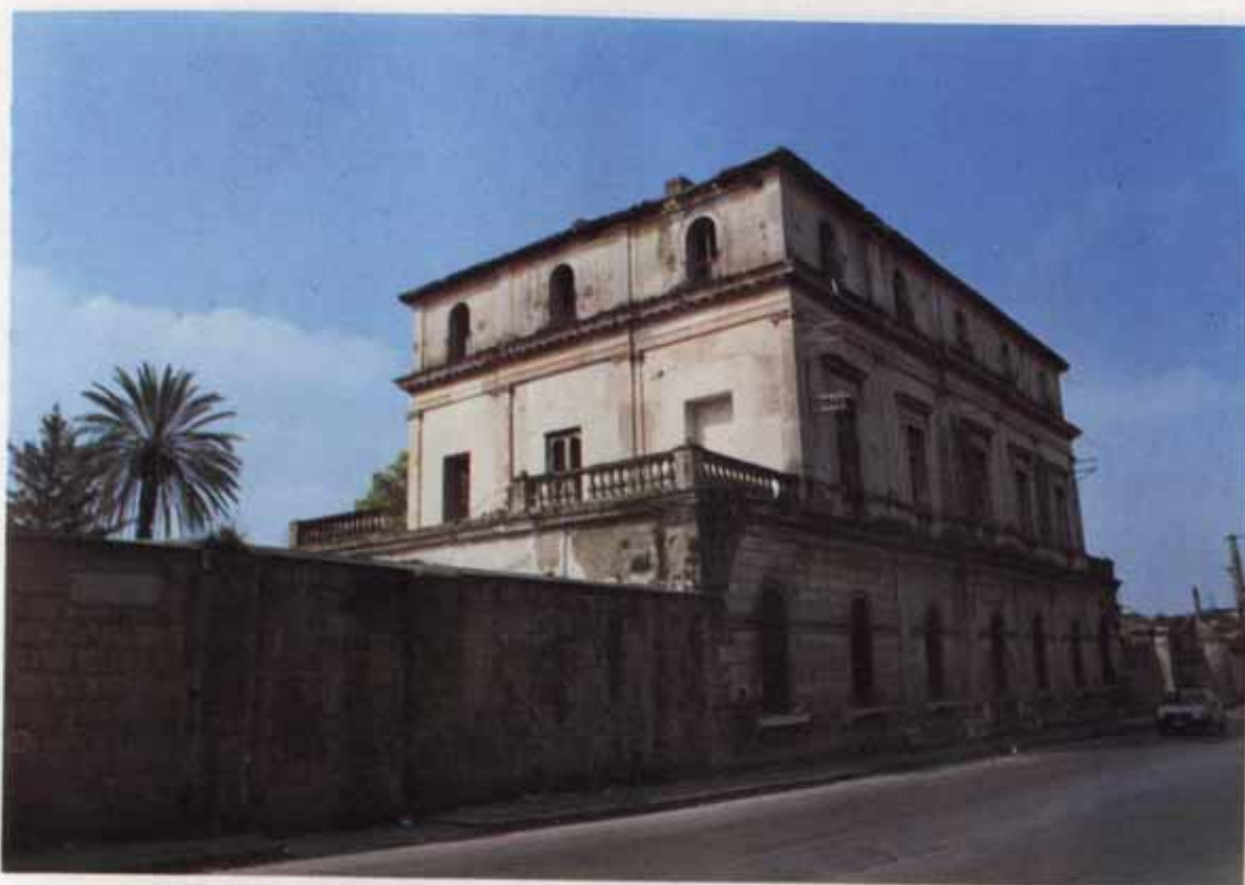
Fot. 1. - Villa Rosa a Caserta . Villa urbana del XIX secolo, con parco giardino circondato da alto muro di cinta, in cattivo stato di conservazione e quindi disabitata. Ha una struttura a blocco su tre livelli, con terrazzo laterale, non possiede alcun servizio rurale e non ha subito trasformazioni.
