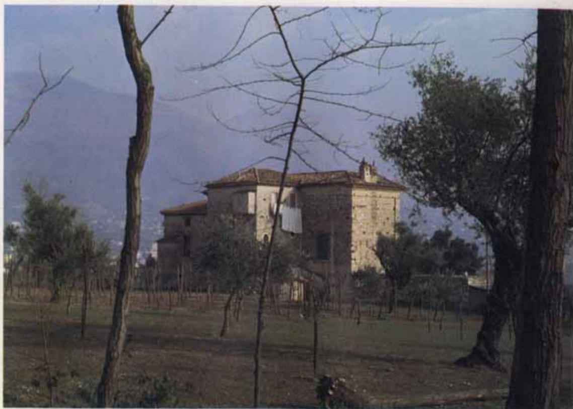
Fot. 37. - Ex-Casino Gaetani D'Aragona, ora Casino della Contessa a Piedimonte Matese. Sorge su un colle che domina la Piana Alifana. Originariamente a blocco, oggi si presenta a T per l'aggiunta di corpi di fabbrica ed è in cattivo stato di conservazione. Edificato nel XVIII secolo, aveva funzioni diverse: agricolo-residenziale e casino di caccia. Attualmente è residenza non agricola. L'edificio presentava un sistema fognario terminante a cielo aperto nella campagna ed era strutturato su due o tre livelli con sottotetto. Il fondo annesso, sia pure di modeste dimensioni, era utilizzato quasi esclusivamente per colture seminate, a cui oggi si unisce un vigneto.
