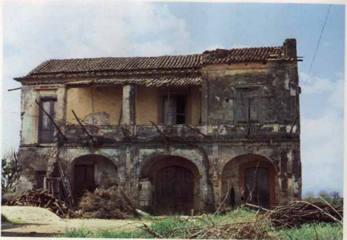
Fot. 35. - Casino Pigna a Bellona . Costruzione del XIX secolo, a blocco ed in cattivo stato di conservazione, con funzione agricolo-residenziale. Sorge in una zona pianeggiante, è dotata di soli depositi di prodotti ed attrezzi vari e non ha subito alcuna trasformazione edilizia. Oggi disabitata, al secondo livello si accedeva per una scala esterna poi crollata.
