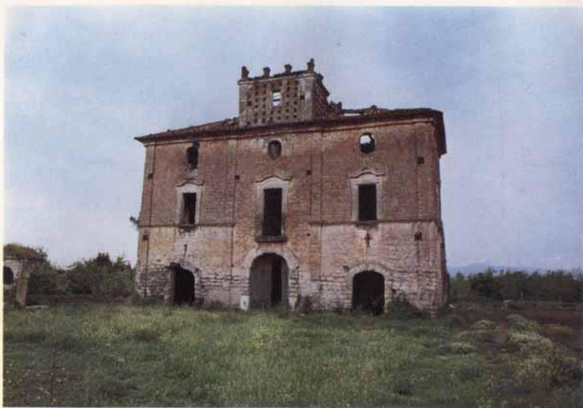
Fot. 12. - Villa La Palombara a Capua . Edificio a blocco del XIX secolo, in pessimo stato di conservazione, sorto con funzione agricolo-residenziale. Situato in zona pianeggiante, si presenta su due livelli con torretta e piccionaia centrale. Il fondo annesso un tempo era a seminativo ed a colture legnose, mentre oggi è stato lottizzato: la villa, esaurita la sua funzione, ha mutato la destinazione dei servizi rurali, posti sul retro dell'edificio, e poi è stata abbandonata.
