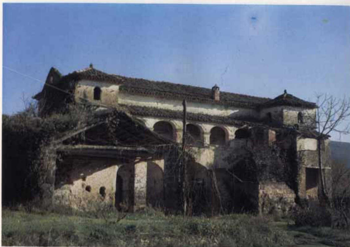
Fot. 27. - Masseria Sansuro a Valle del Pidocchio (comune di Pontelatone). Ex-proprietà del principe di Formicola, la costruzione del XVII secolo, in pessimo stato di conservazione, è sita in zona collinare ed ha una struttura a blocco, con due corpi avanzati laterali a forma di torre con piccionaia ed un loggiato sorretto da archi. Presenta due piani con scantinati, stalla, cantina e depositi per i prodotti e gli attrezzi. Oggi disabitata, è un esempio di edificio extraurbano, con giardino, legato allo sfruttamento fondiario.
