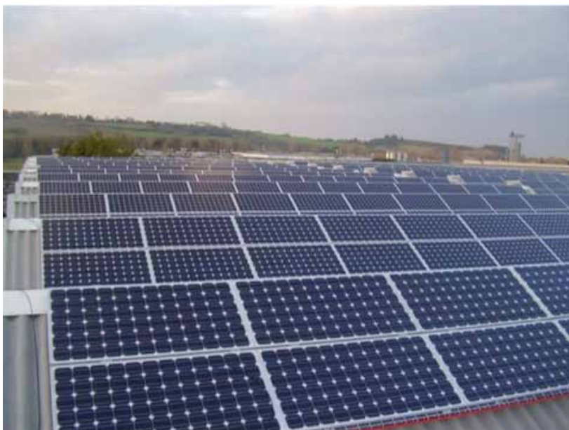
Fig. 7 - Fotovoltaico su copertura a shed
