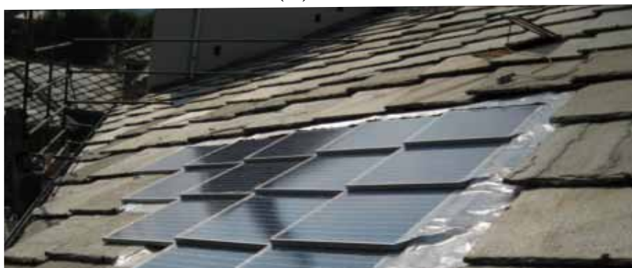
Fig. 5 - Il progetto pilota della “losa” fotovoltaica installata sulla copertura della Scuola Elementare di Luserna S. G. (TO)
