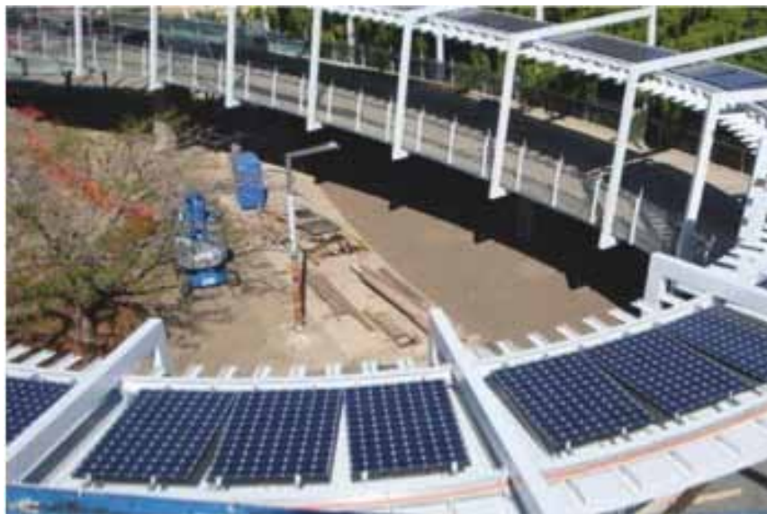
Fig. 11 - Ponte di Kuripla (Brisbane); dettaglio della copertura della passerella con pannelli fotovoltaici
