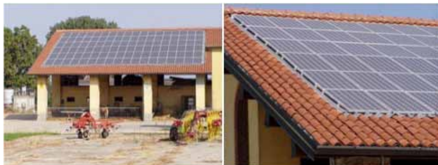
Fig. 3 - Fotovoltaico su copertura a falda. Copertura Sud Est della cascina Menozzi di Landriano (pv)
