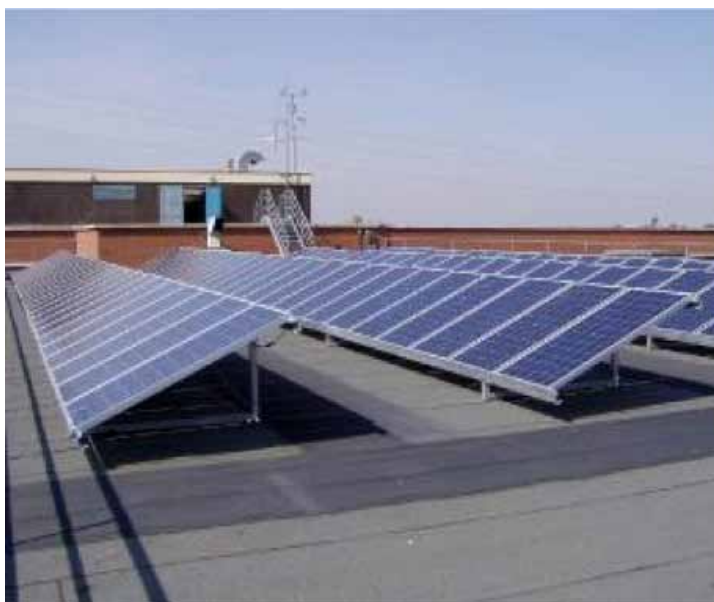
Fig. 6 - Impianto fotovoltaico con struttura metallica collocato su copertura piana
