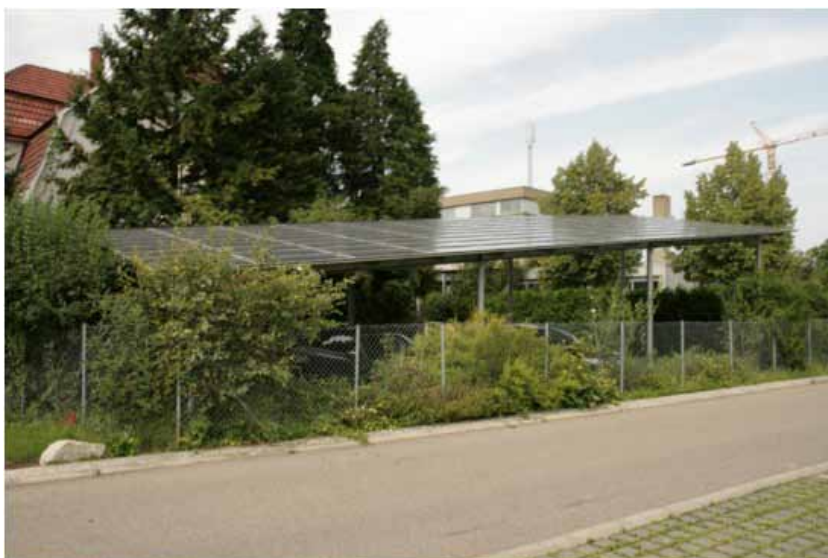
Fig. 8 - Copertura fotovoltaica per posteggio privato
