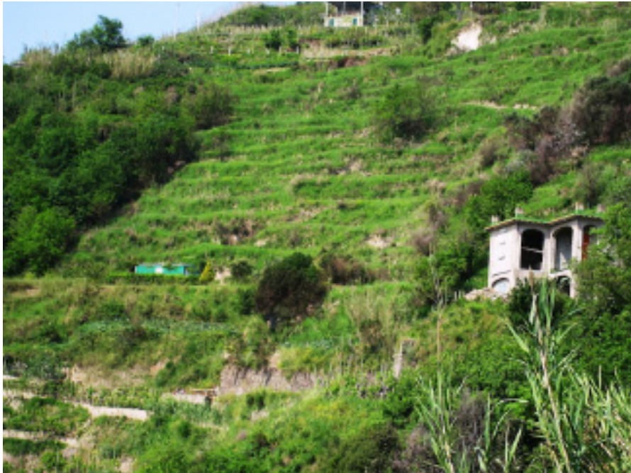
Fig. 5 - Campo terrazzato non più coltivato, dove i terrazzi sono in disfacimento
