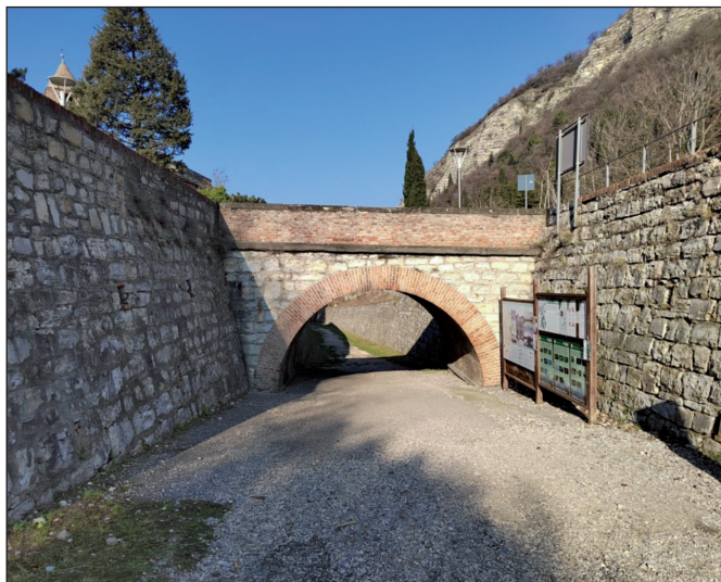
Fig. 7 - Il ponte in piedritti presso il Monastero di San Pietro in Lamosa di Provaglio d'Iseo visto da nord, all'ingresso dell'itinerario ciclopedonale delle Torbiere del Sebino. Si noti l'innalzamento del piano stradale dovuto all'accumulo dei detriti
